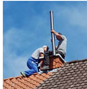
Abb. 9: Vorsicht bei Dacharbeiten
