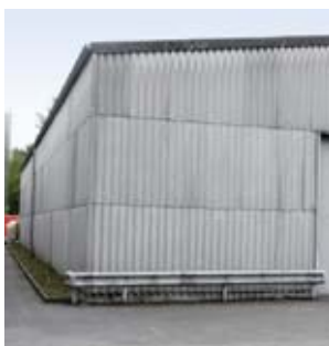
1 Mit asbesthaltigen Platten verkleidete Fassade
