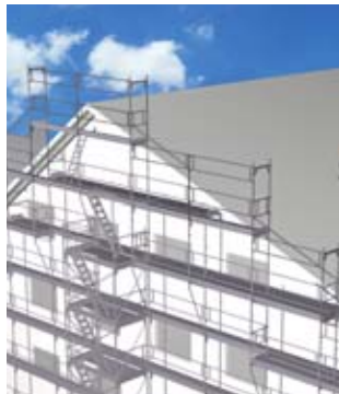
Regel 2 Absturzkanten sichern.
